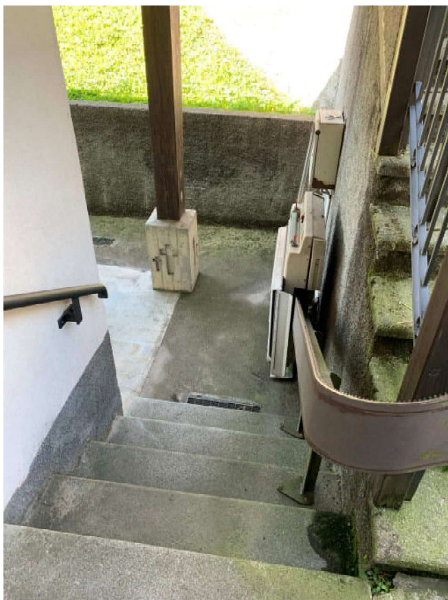
SERVOSCALA ASSISTITO SITUATO NELL'EDIFICIO IN LATO EST
