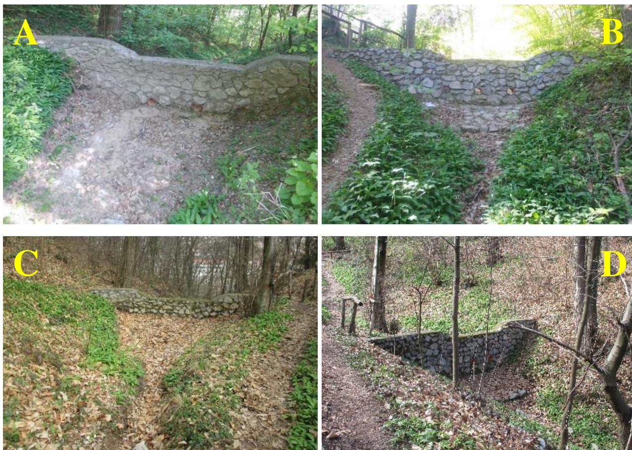
Confronto tra la situazione dell'alveo presso la briglia esistente nell'aprile 2015 (A = lato monte. B = lato valle) e quella di gennaio 2016 (C = lato monte; D = lato valle). Il fogliame accumulato chiude le feritoie della briglia filtrante; in C si nota anche il piccolo solco d'erosione a monte della briglia.
