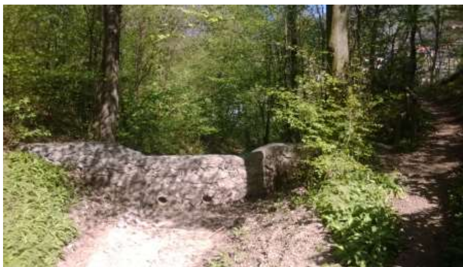
Figura 4. Ripresa fotografica dell'esistente briglia in pietrame per il contenimento del trasporto solido.
